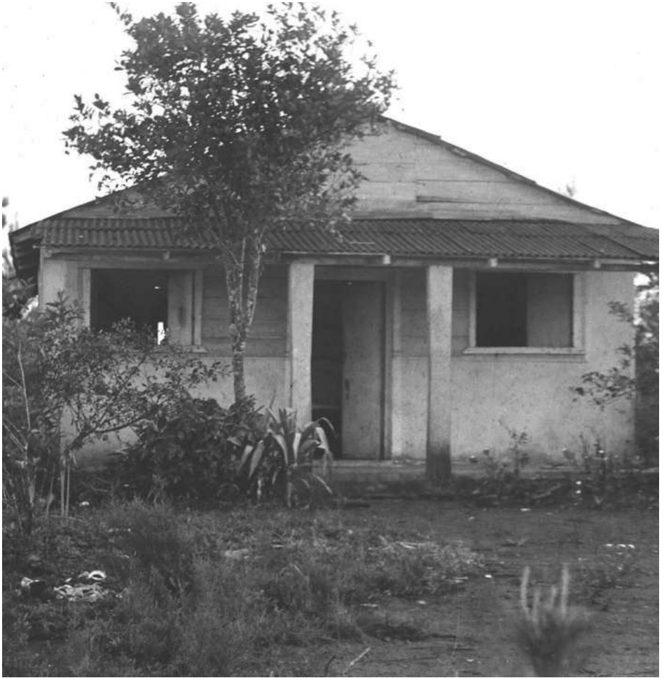
La ruinoso residencia de la Reserva Natural de Cupeyal del Norte, marzo de 1987
